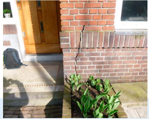
Figuur 20: Gevel met een scheur als gevolg van schade aan de fundering (BVL)
