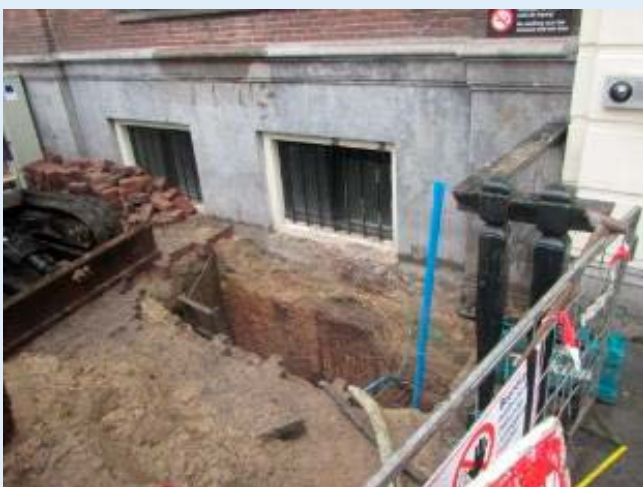
Figuur 42: Metselwerk bij een paalfundering en peilbuis voor lokale grondwaterstandsmeting (Aveco de Bondt)
