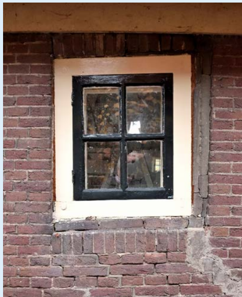
Figuur 18: Te inspecteren gevel met gerepareerde en bestaande scheuren (AdP)
